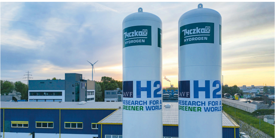
Wasserstofftanks am Sitz von IAVF in Karlsruhe: Hier entsteht eine firmeneigene H 2 -Infrastruktur
