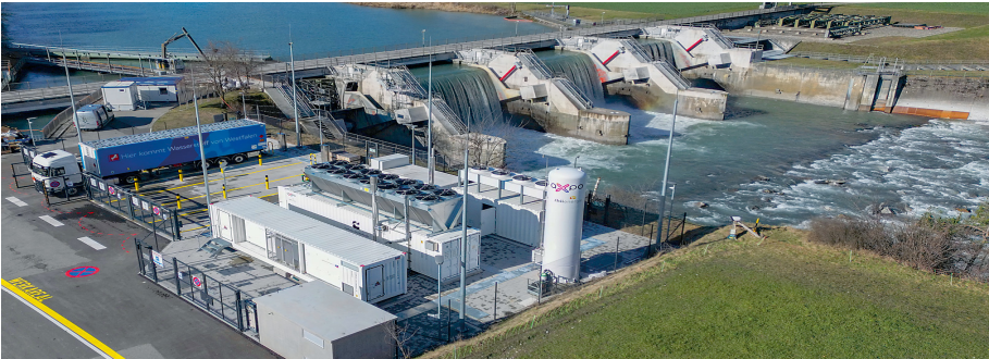
Die Wasserstoffproduktionsanlage des Projektpartners Axpo Solutions AG in der Schweiz
